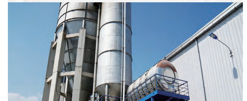
Water Recycle System / 廢水廢料回收再利用系統
