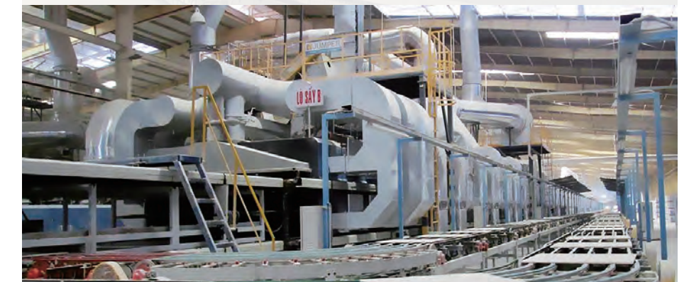
Heat Recycle System / 熱能回收系統
